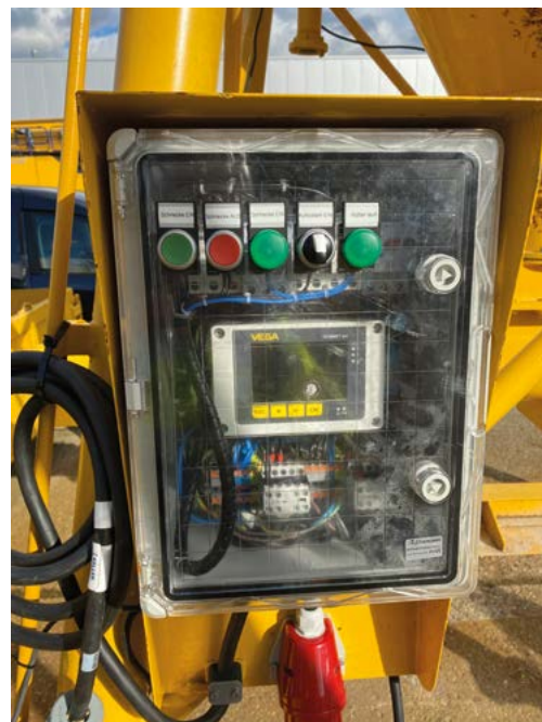
Automatisierte Füllstandbestimmung am Silo
